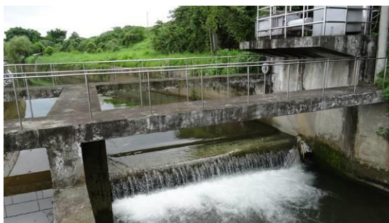
食水嵙溪上游閘門
